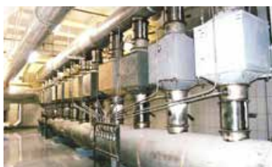
Вытяжные системы комплекса зданий с фильтрами
