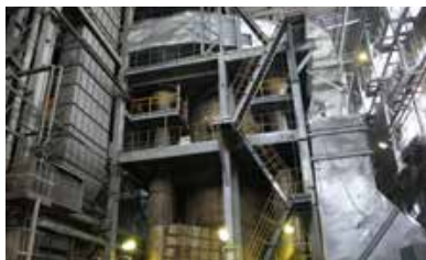
Золотулавливающая установка котлоагрегата № 2
